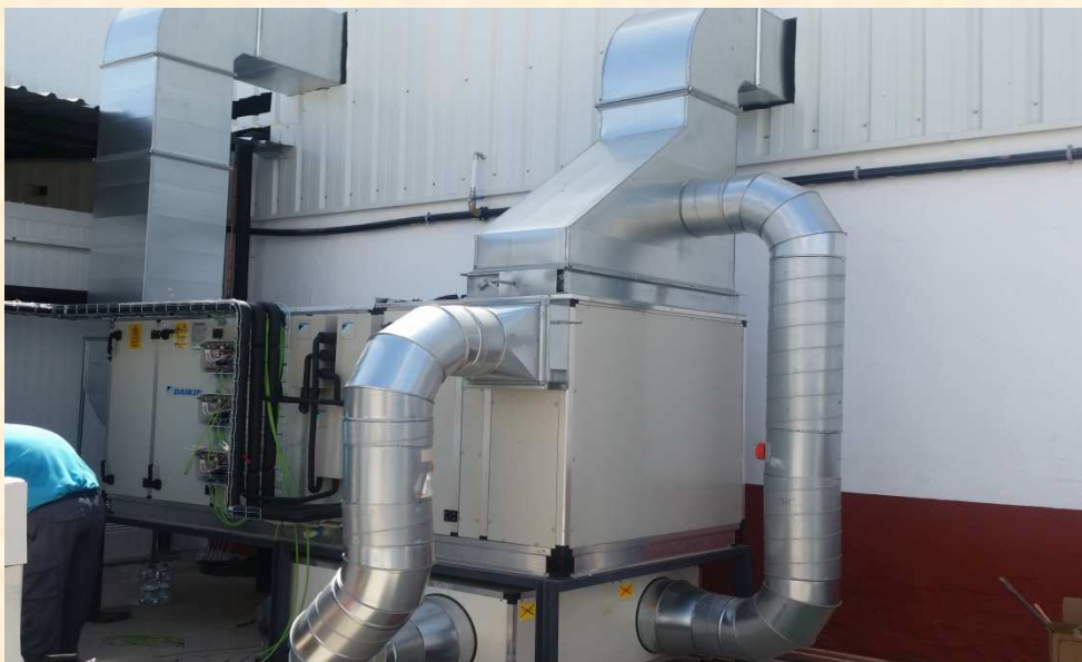
Climatizador Daikin con 84 kw en expansión directa más recuperador de calor
